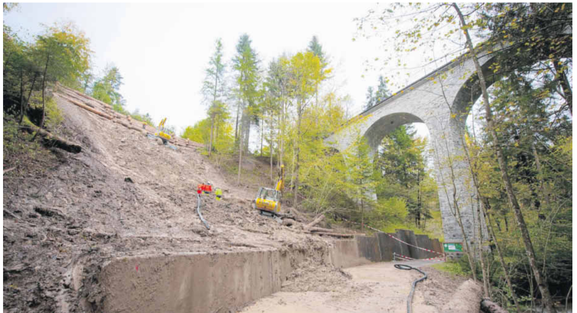
Eine Schlammlawine verschüttete den Wanderweg. Gestern sicherten Arbeiter mithilfe zahlreicher Geräte und eines Helikopters den Hang. Bild: David Kündig
