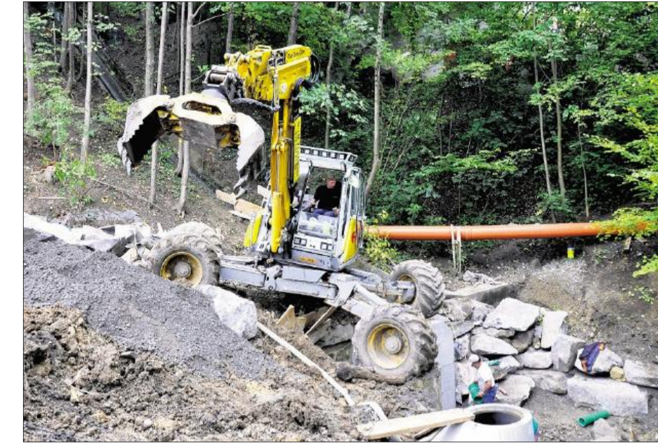
Die Arbeiten im Klingenbachtobel sind noch voll im Gange. Bald fliesst hier sauberes Bachwasser. (Andreas Faessler)
