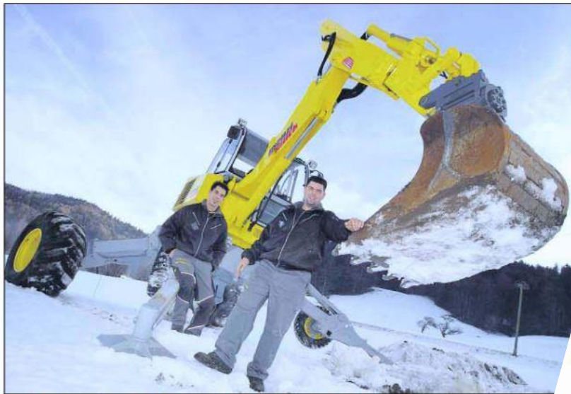
Bereit für neue Einsätze: Stolz präsentieren Marco (links) und Guido Korrodi ihren Schreitbagger. (Bild: Thomas Halliger)
